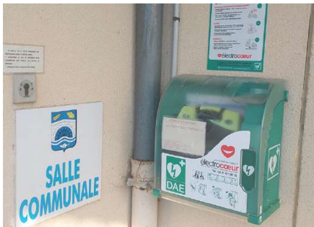
Pour répondre à ses obligations légales, la commune a installé un défibrillateur à la salle communale
